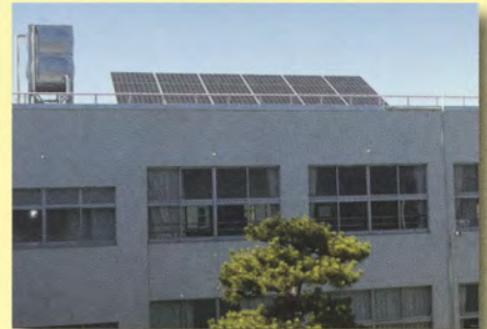
屋上に設置された太陽光パネル
